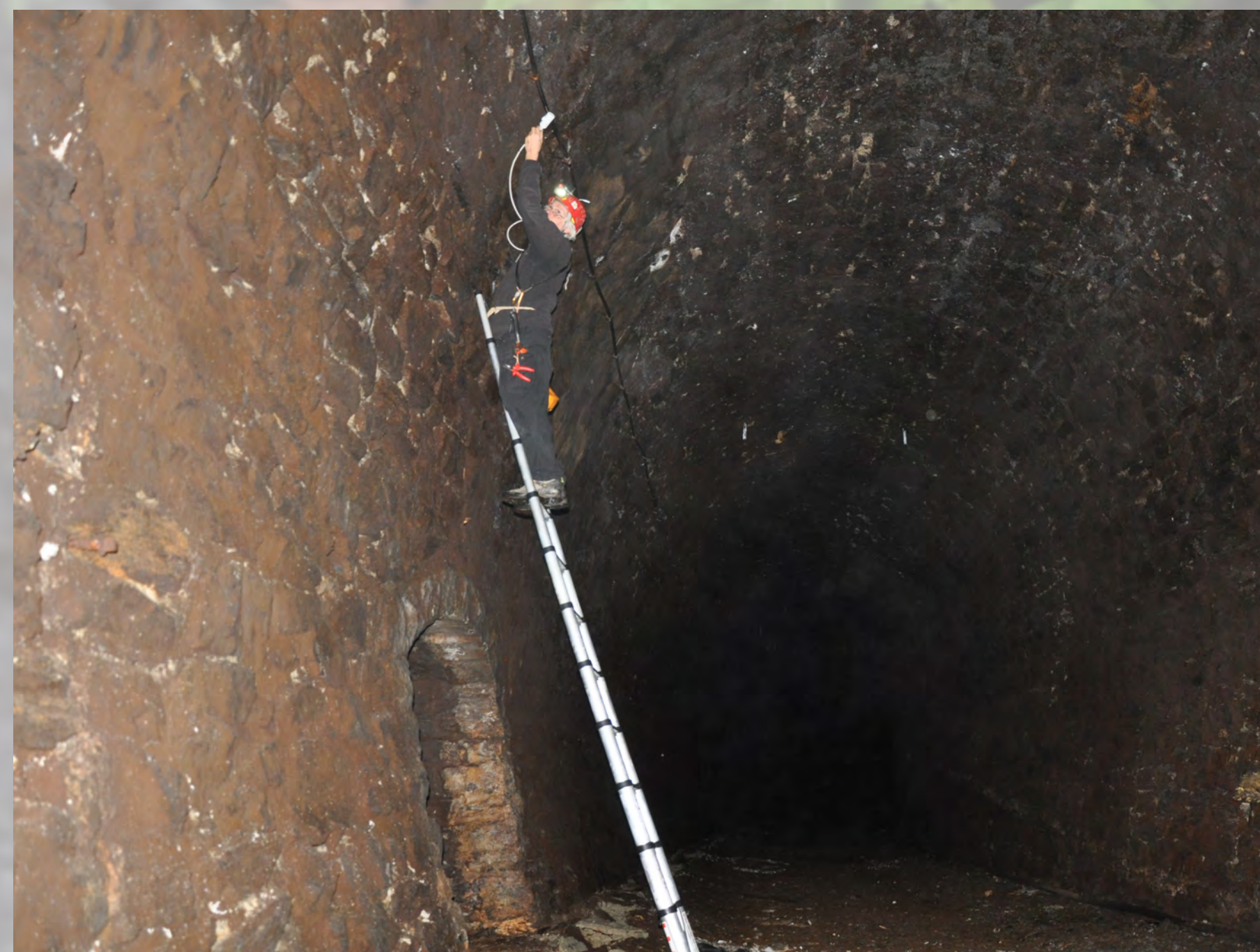
2. Datalogger werden an den Tunnelwänden montiert. Sie liefern Informationen über die Luftfeuchtigkeit und Temperatur im Inneren der Tunnel.
