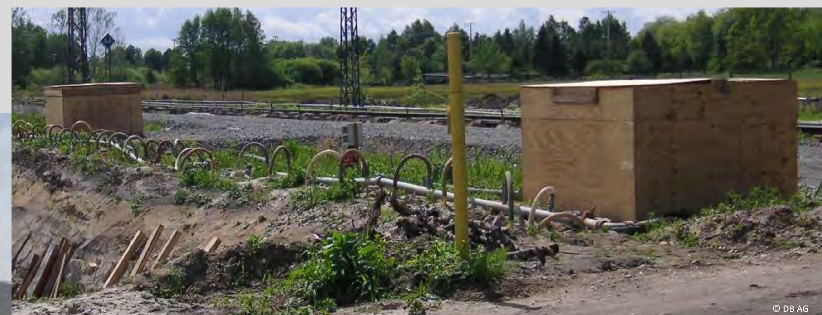
Bauvorhaben „Kreuzungsbauwerk Elsterwerda“: Zur Minderung des Baulärms wurden die rund um die Uhr arbeitenden Vakuumpumpen mit gedämmten Holzeinhausungen gekapselt.
