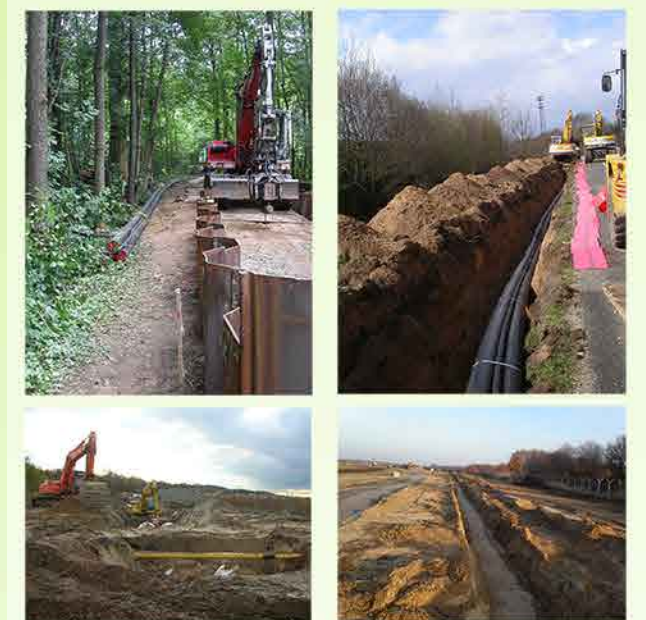
Beispiele aus dem Bauablauf bei der Verlegung von Strom- und Wasserleitungen: Herstellung von Baugruben (Bohrverfahren), Verlegung in den offenen Leitungsrinnen, Herstellen von Anschlussbauwerken, Wiederverfüllung
