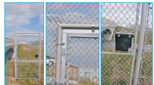
Behebung von Schwachstellen (zu breite Zwischenräume)
