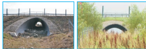
Durchlass als Wellstahlprofil im März und August 2010
