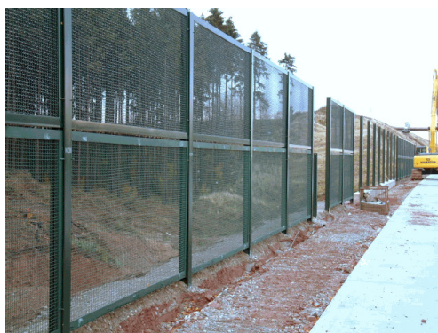
BAB A38 (VKE 5612) westlich Heilbad Heiligenstadt mit Fledermausschutzzaun und Unterführung in ca. 50 - 100 m Entfernung
